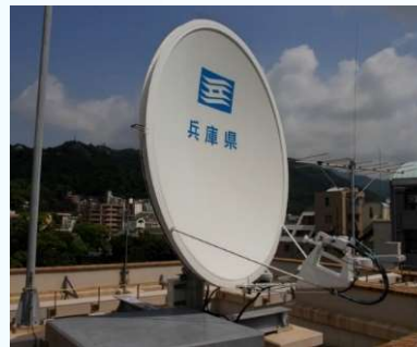
▲衛星アンテナ (災対センター屋上)
