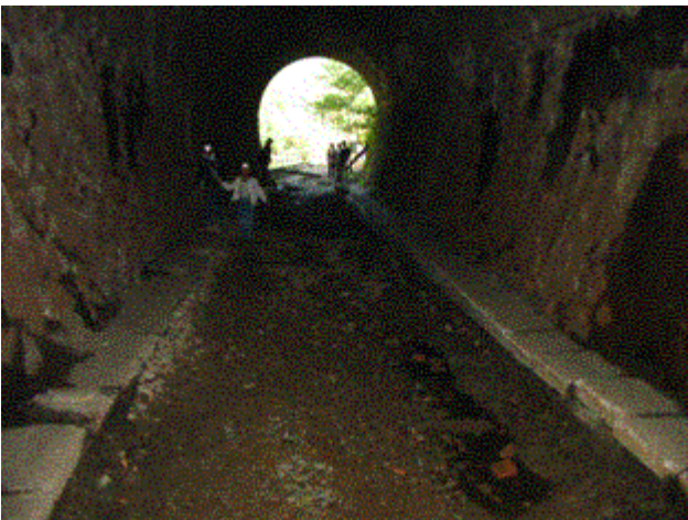
長尾山第1トンネル内部流失（上流側）
