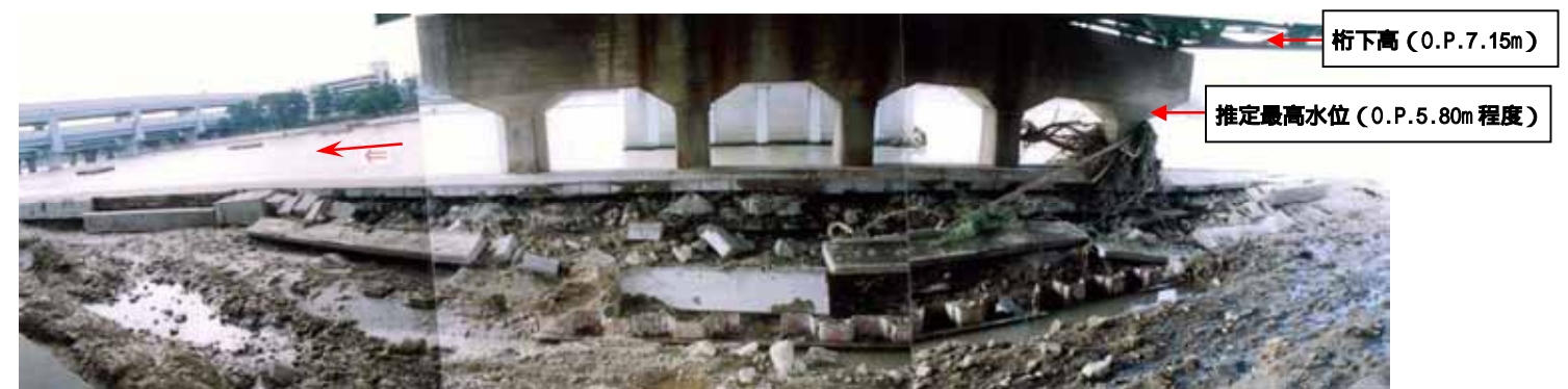
図 平成 16 年台風 23 号後の阪神電鉄橋梁の状況（草薙委員提供：第 26 回流域委員会 資料 3 より再掲）
