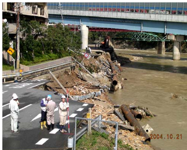
写真 2.2.2 平成 16 年台風 23 号の被災写真 (生瀬大橋上流右岸側)
