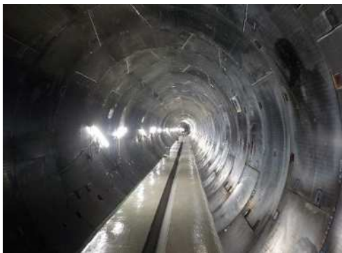
合流貯留管<106路線>(H28)
