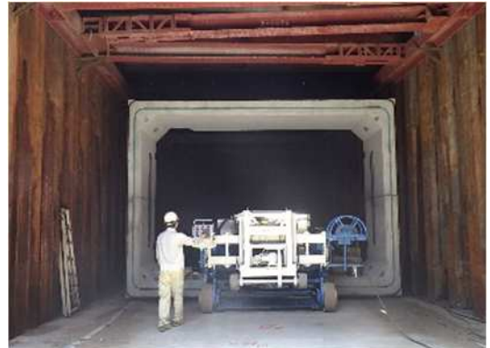
オフサイト貯留施設：鳴尾駅前雨水貯留施設(H29)
