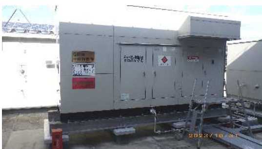
自家発電設備の設置(三田市庁舎)
