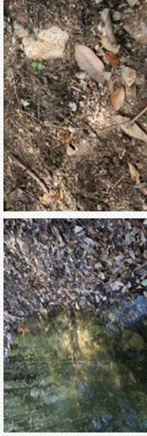
写真、汀線付近の侵食状況
