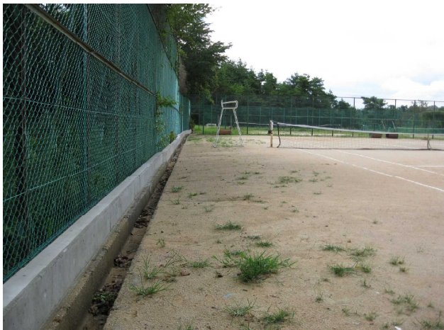
雨水貯留施設 (周囲小堤)
