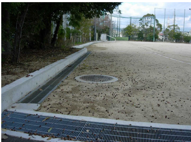
雨水貯留施設 (周囲小堤)
