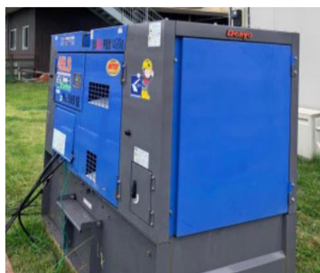
(非常用自家発電設備)
