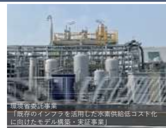
メタネーション実証設備「化けるLABO」 (出典) 大阪ガス
