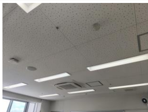
普通教室の空調室内機とLED
