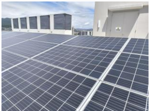
太陽光発電設備
