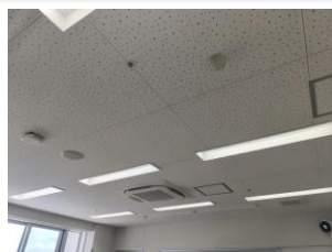
普通教室の空調室内機とLED
