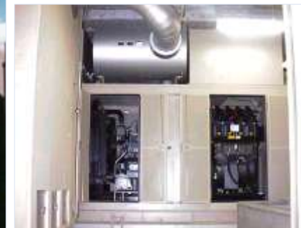
非常用自家発電機
