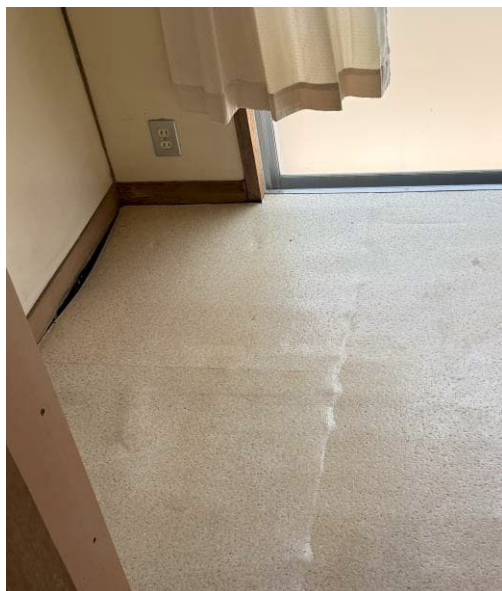
床の経年劣化
