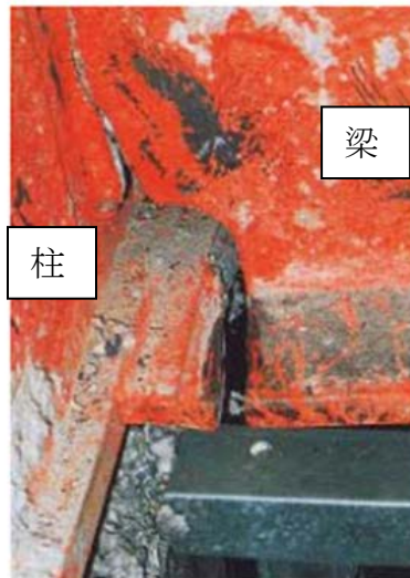
写真 CB1.6.3 下フランジの破断とウェブの亀裂
