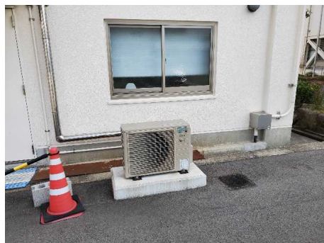
室外機等の高所化（西神戸庁舎）
