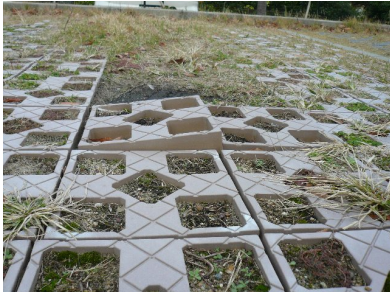
プラスチックブロックが浮き上がった事例
