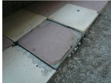
コンクリート平板が破損した事例
