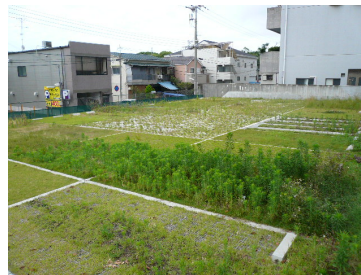
雑草が繁茂し景観性・歩行性が損なわれた事例
