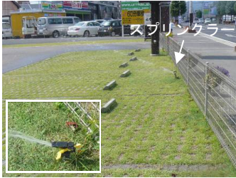
スプリンクラーを設置した事例
