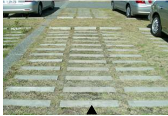
ブロック間隔が広すぎ、タイヤ圧を受けた例
