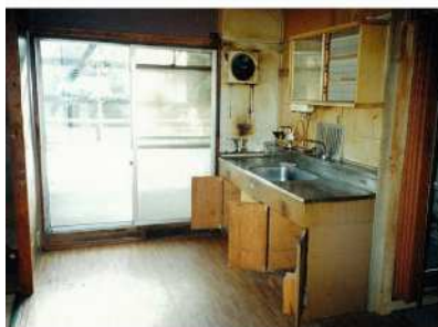
写真-7 (台所：老朽化し手狭)
