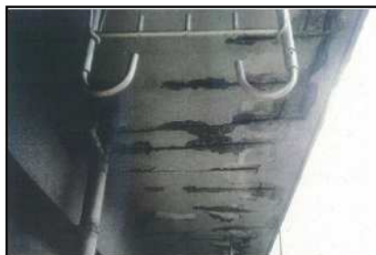
写真-2 (バルコナダ下露筋状況)
