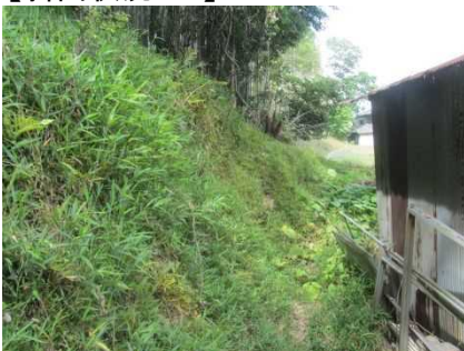
②斜面状況(人家裏)
