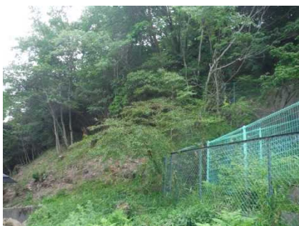
②斜面状況(人家裏)
