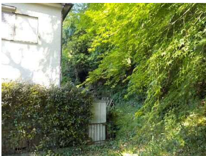
②斜面の状況(人家裏)
