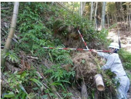
②斜面状況(人家裏)
