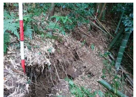
④斜面状況(人家裏)
