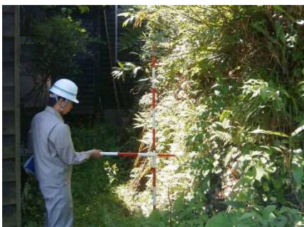
②斜面状況(人家裏)
