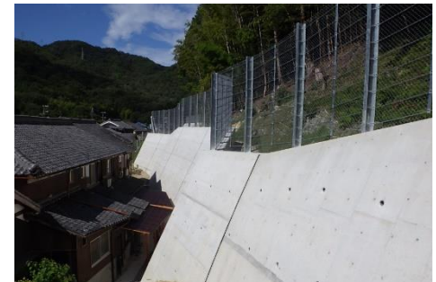
中須加院地区 急傾斜地崩壊防止施設 (姫路市)
