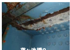
落ヶ池橋2 【鋼桁の腐食】
