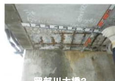
岡部川大橋3 【床版の損傷(鉄筋露出)】
