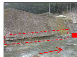
河床の低下で護岸が 危険な状態でした。
