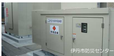
屋上階自家発電設備（伊丹市）
