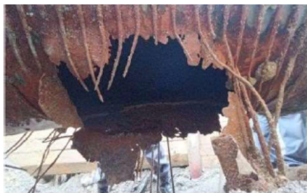
破損したPCPの状況
