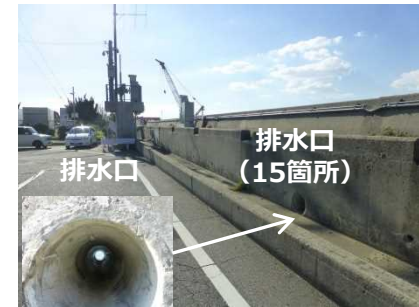
写真8. 鳴尾浜排水口
