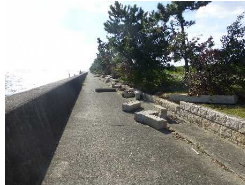
写真4. 越波による植栽帯の被災状況
