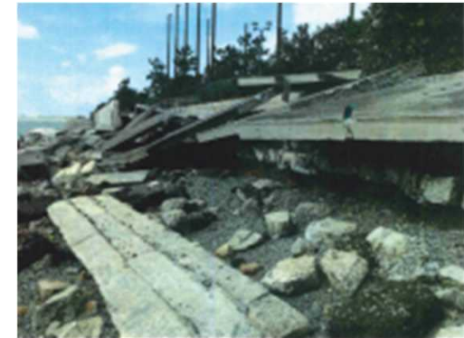
写真5. 東側の防潮堤の被災状況
