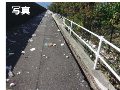
写真9. 防潮堤背後の越波状況
