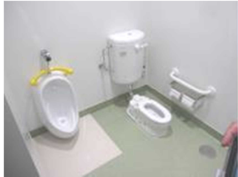
児童スペースに子どもトイレを設置
