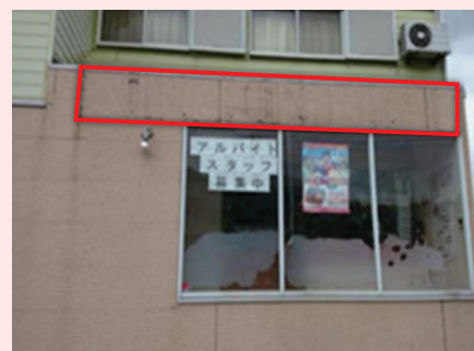
落下した後の壁面
