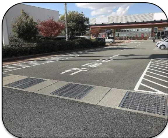
路面標示による注意喚起
