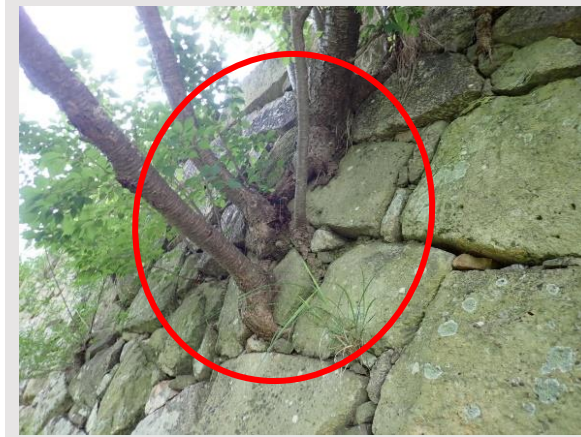
【天守台東】（2023年7月） 樹木の生長に伴い、石垣を壊す恐れがある。
