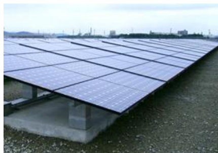
太陽光発電施設の設置例
