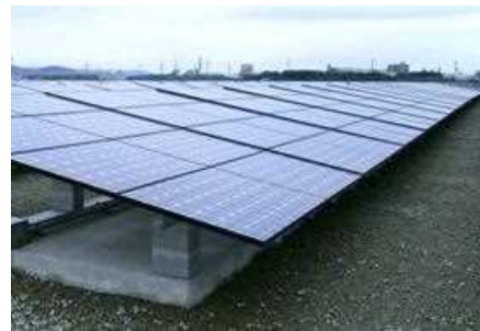
太陽光発電施設の設置例
