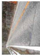
(舗装のひび割れ)
