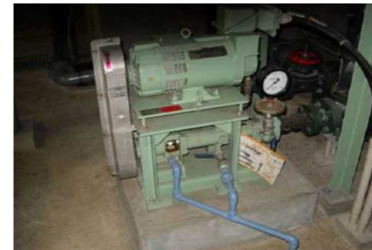
薬品供給ポンプ(増設)
