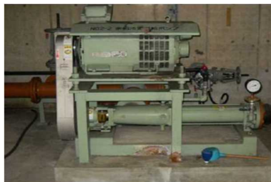
余剰汚泥供給ポンプ(既設を撤去し更新)
