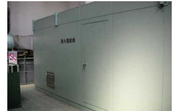
既設No.1、No.2遠心濃縮機(今回工事で撤去)
