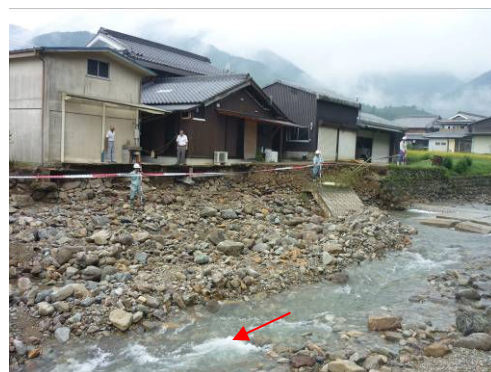
写真 1.2.8 多田川 多田公会堂付近右岸被災状況
