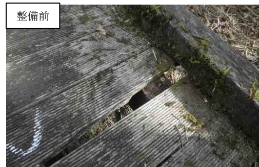
老朽化した園路
