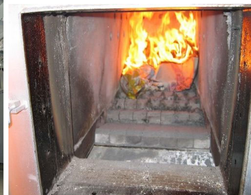
木質バイオマスチップボイラー (ボイラー内部)
