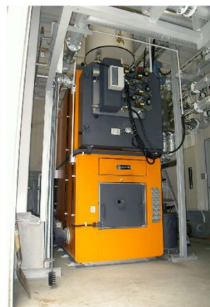
木質バイオマス チップボイラー
