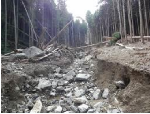
溪流侵食状況 (平成26年8月：丹波市)
