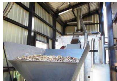
竹チップボイラー（淡路市）
