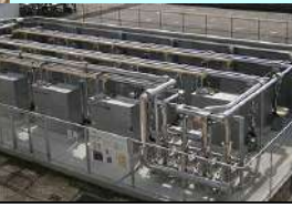
発電機 (25kW×14台)
