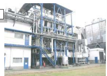
蒸気ボイラー施設
