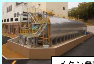
メタン発酵槽 (1,000m 3 )
