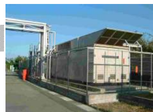
発電施設 (ガスエンジン)
