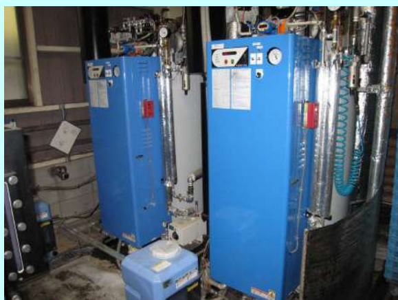
廃油ボイラー
