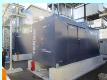
発電機 (360kW×2台)
