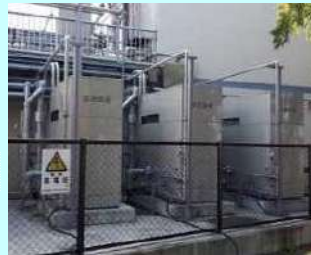
発電機 (25kW×3台)
