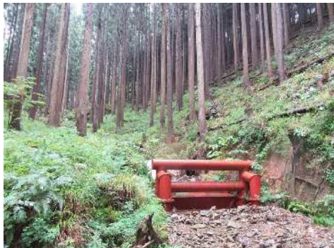
簡易流木止施設
