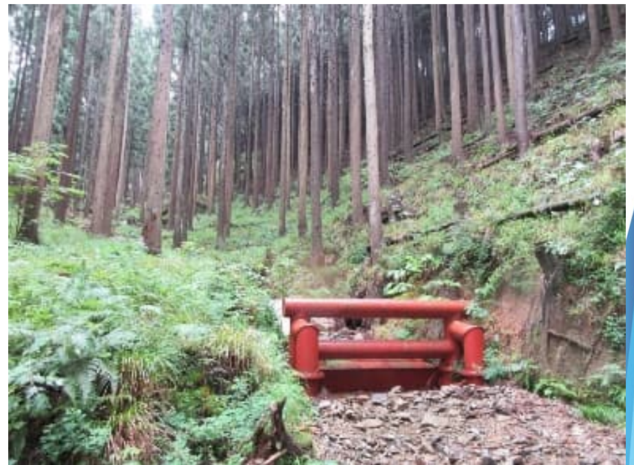
写真 簡易流木止め施設
