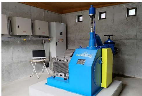
小水力発電所（宍粟市）
