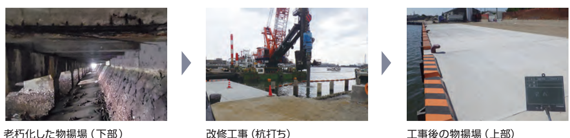
老朽化した物揚場（下部）
