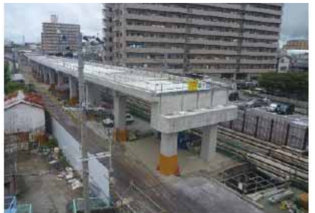
連続立体交差事業の推進：山陽電鉄西新町駅付近(明石市)
