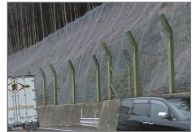
落石防止ネット 国道 373号 (佐用町)
