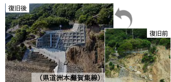
道路の災害復旧
